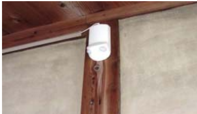
< 高齢者宅内の柱に設置されたセンサー >
